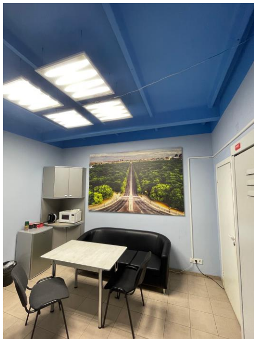
Освещение офисных помещений автоцентра
